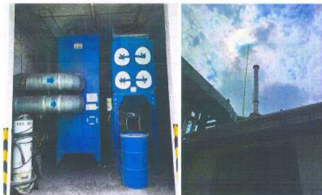
Hệ thống xử lý khí thải (xử lý bụi DFE và hấp phụ than hóa tính)
